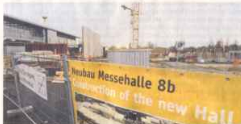
Am Nordrand der Messe ist die Baugrube für die neue Ausstellungshalle bereits ausgehoben. Im September öffnet sie.
